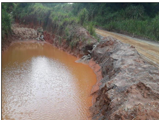
Foto 07 – Vista parcial do sistema de drenagem do empreendimento - dique de decantação. PCA (Belmont, 2020).
