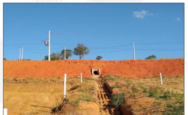
Foto 06. Sistema de drenagem.
