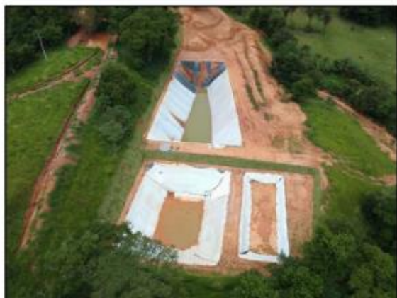
Foto 03: sistema de tratamento- Lagoas de tratamento
