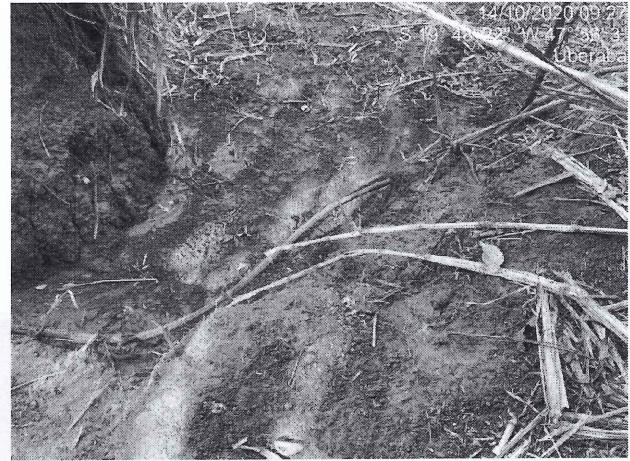
Figura 14 – Vista da área onde está prevista as obras do dissipador de energia. (vestígios de processo erosivo).
