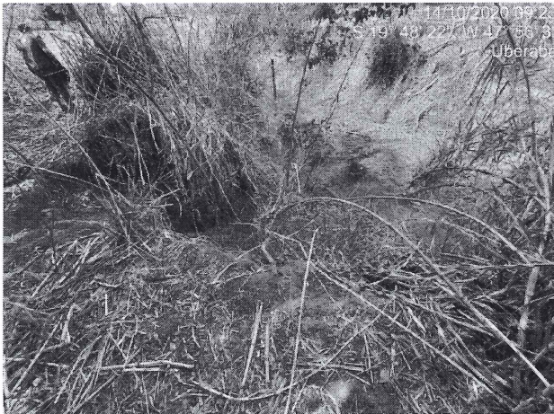
Figura 13 – Vista da área onde está prevista as obras do dissipador de energia.
