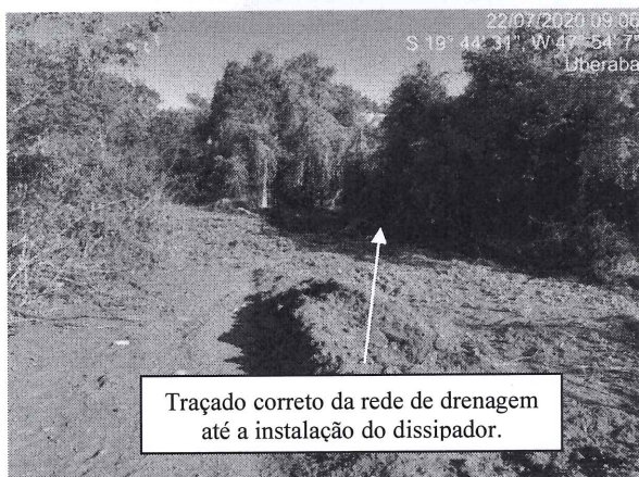
Figura 01: Vista parcial da Área Verde que passou por supressão irregular. Parte inicial do traçado da rede de drenagem até o dissipador
