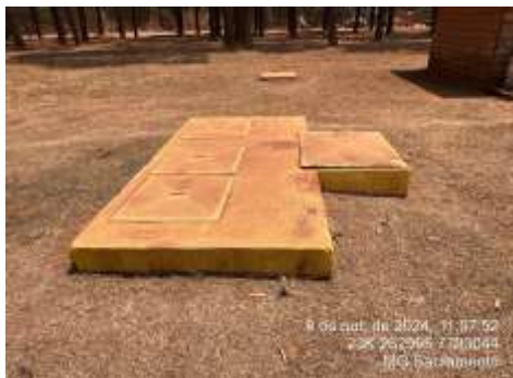
Foto 7. Caixa Separadora de Água e Óleo – CSAO. Fonte: Laudo Técnico e fotográfico de Vistoria Remota (2024)/Totus ambiental consultoria e projetos.
