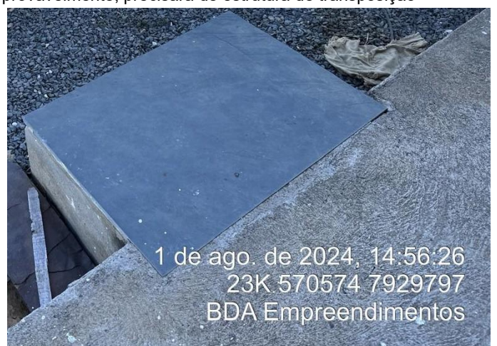
Foto 12: Possível observar que as tampas do biodigestor foram concretadas.
