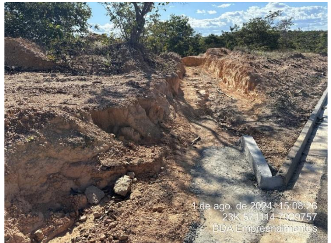
Foto 20: Local onde o empreendimento abriu espaço para que o efluente pluvial escoasse, porém estão ocorrendo processos erosivos.
