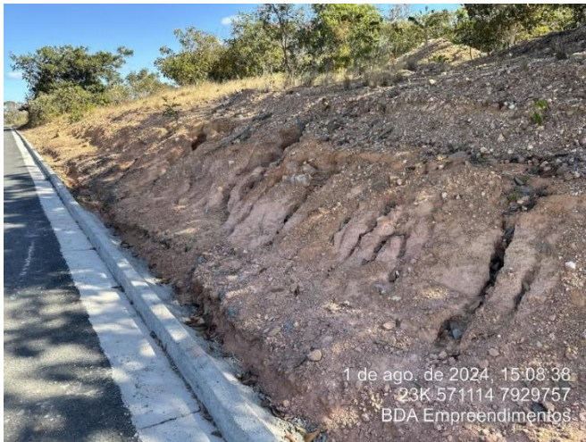
Foto 19: Início de processos erosivos em via já pavimentada.
