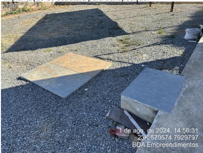
Foto 11: Biodigestor associado à portaria.
