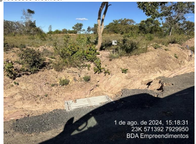
Foto 22: Processo erosivo em via já asfaltada e com bueiro instalado.
