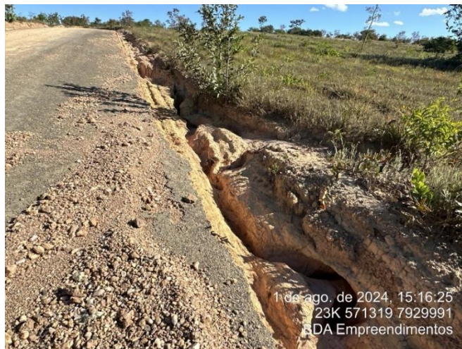
Foto 21: Processos erosivos na lateral de via já asfaltada.
