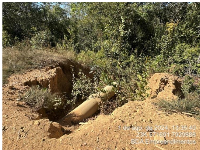
Foto 26: Vista lateral da manilha instalada para que os efluentes oriundos da drenagem superficial desaguem no corpo hídrico. Obra ainda está inacabada.
