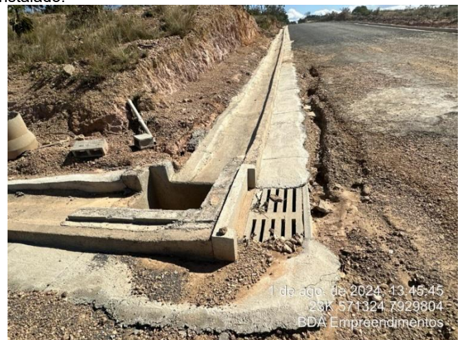
Foto 24: Exemplo de bueiro implantado para contemplar o sistema de drenagem superficial.
