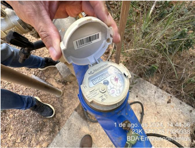
Foto 15: Hidrômetro e torneira associados ao poço.
