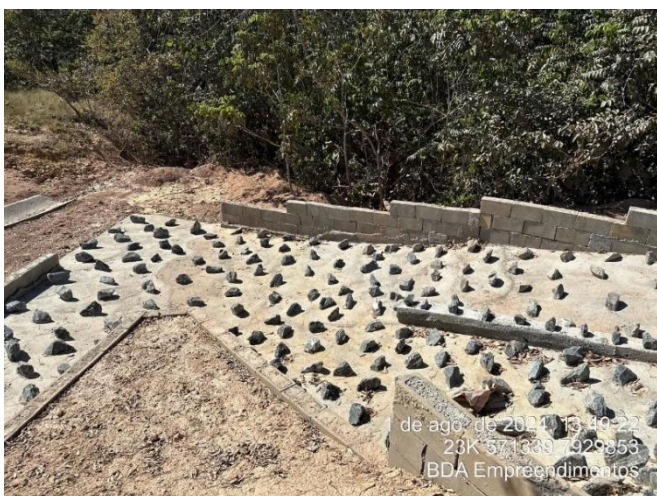
Foto 27: Parte da área implantada pelo próprio empreendimento, sem projeto prévio de drenagem, para corrigir erosões.
