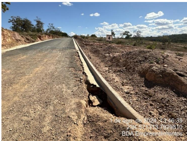
Foto 23: Exemplo de canaleta implantada em via pavimentada já danificada por erosões.
