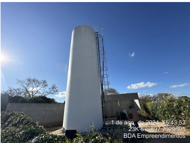
Foto 5: Caixa d'água que abastece o loteamento.
