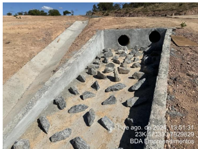
Foto 30: Ponto de chegada dos efluentes de montante.
