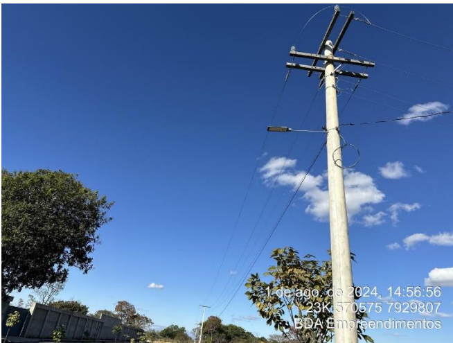
Foto 3: Poste com fiação já instalado.
