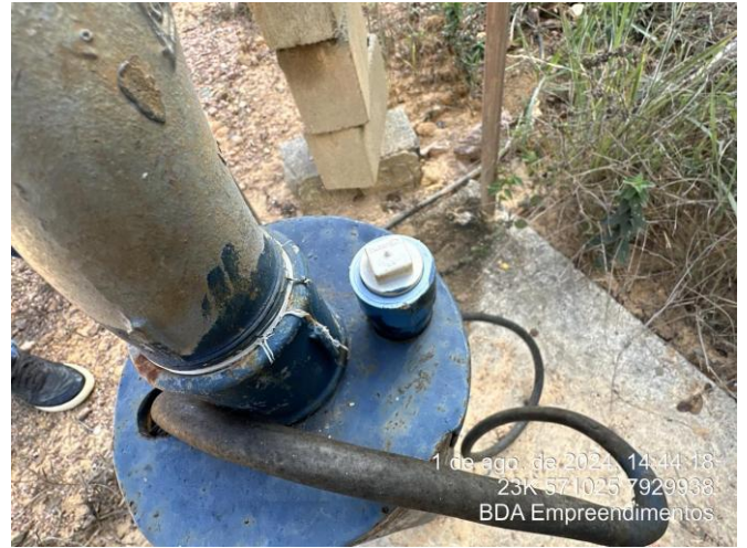
Foto 16: Tubo guia associado ao poço.
