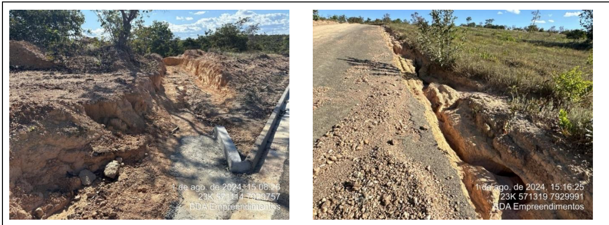
Figura 6. Processos erosivos identificados no empreendimento.
