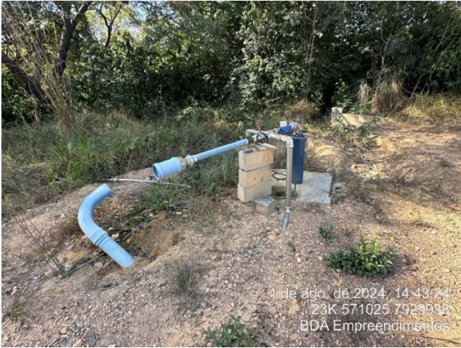
Foto 13: Vista do poço artesiano.
