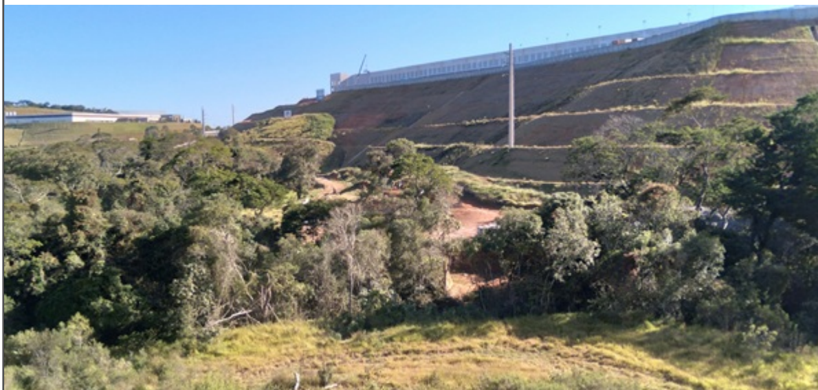
FIGURA 10: Local da intervenção ambiental em APP no Rio Camanducaia, denominada Trecho 2, com e sem supressão de vegetação nativa, presente na propriedade Gleba nº. 01, bairro dos Pessegueiros, município de Extrema/MG.
