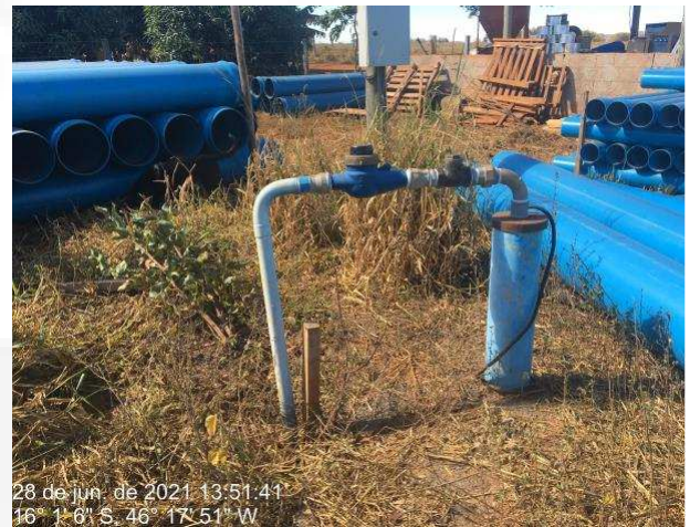
Foto 04. Ponto de captação em poço tubular
