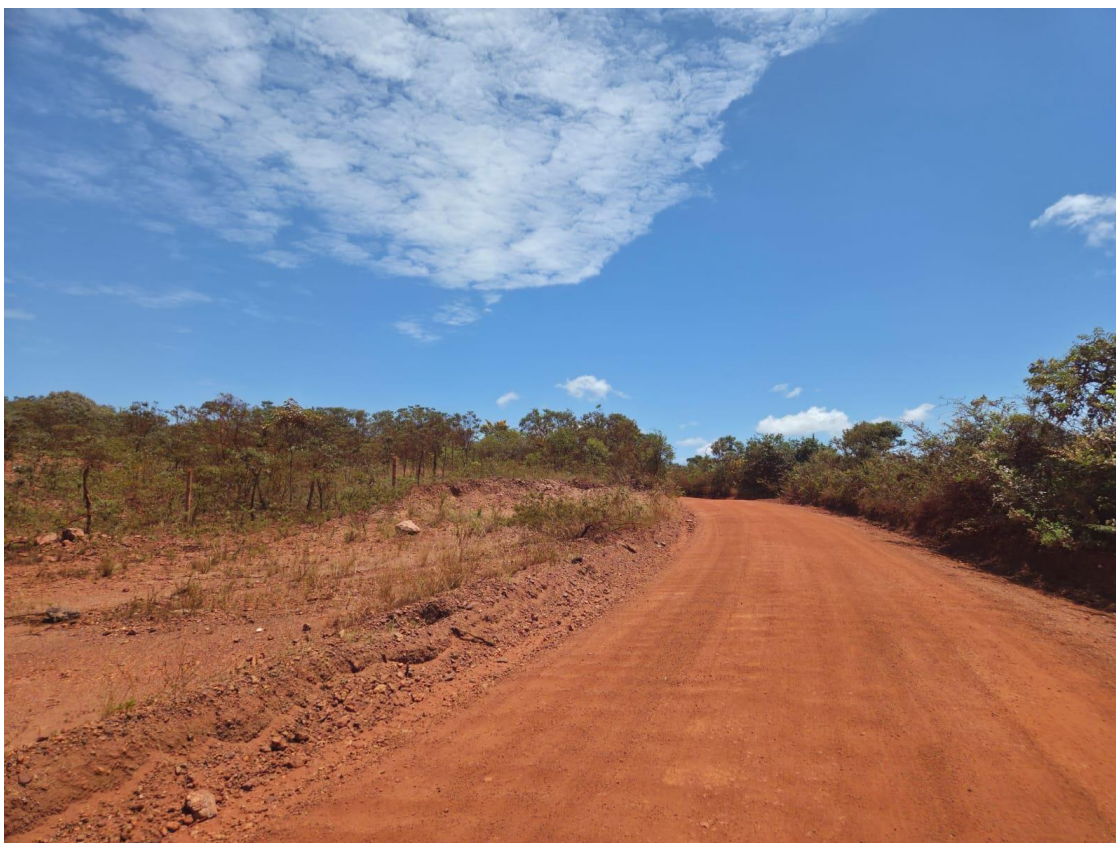
Imagem 1 - Rodovia Municipal - Trecho: Rio Pardo de Minas – Entrº LMG 635 (Santo Antônio do Retiro). Fonte: Acervo URA NM.
