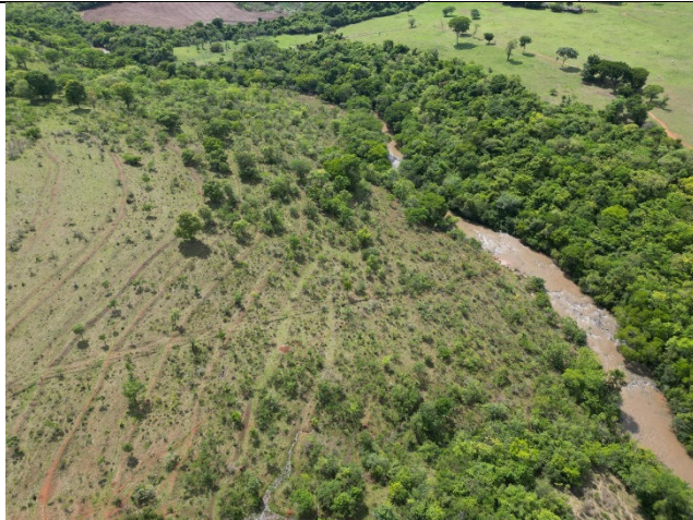
Foto 03: APP do Rio Uberabinha, na área de intervenção para instalação de sistema de drenagem pluvial do loteamento. Fonte: Vistoria Técnica (05/11/2025).
