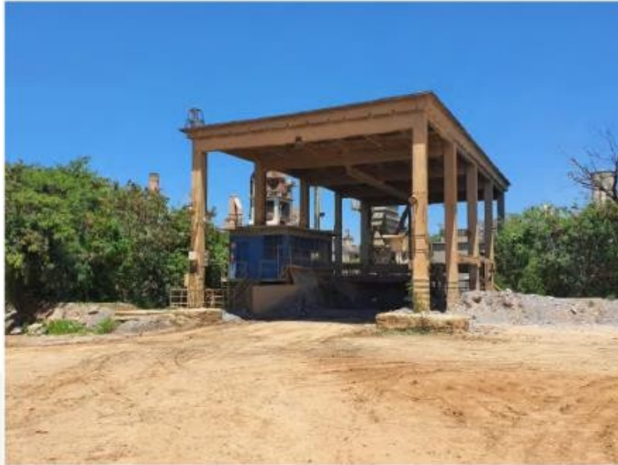
Figura 2.5: Área do britador primário. Fonte: EIA CCA.
