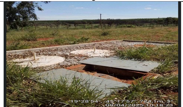
Foto 04. Sistema de Tratamento de Efluente Sanitários
