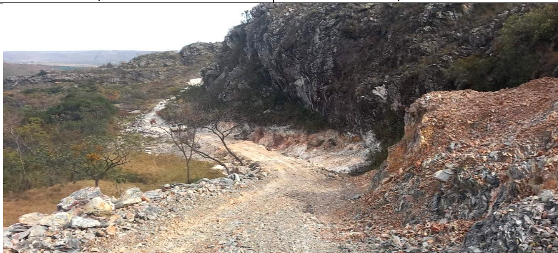
Vista da estrada instalada e com supressão de vegetação nativa em Reserva Legal sem autorização.
