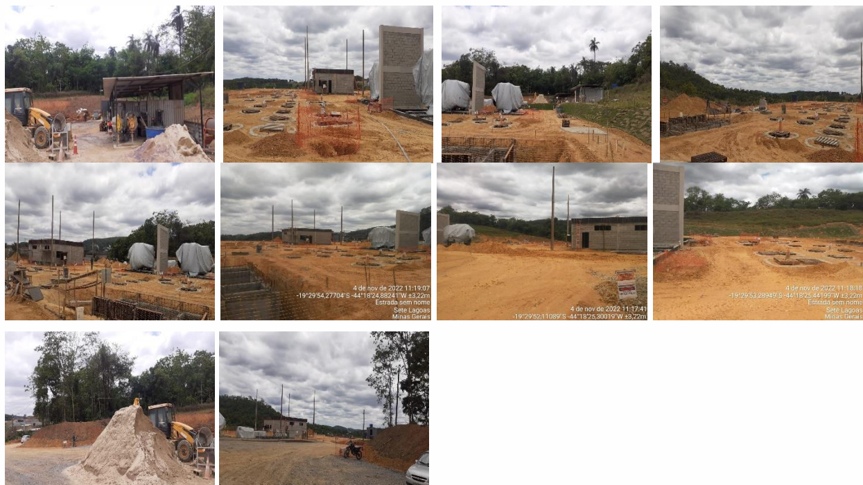
Figura 8 – Imagens capturadas na área solicitada para a instalação da Subestação de Energia Elétrica do empreendimento Multitécnica Industrial
