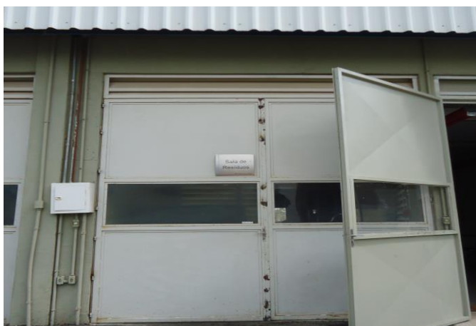
Foto 05. Central de armazenamento temporário de resíduos sólidos.
