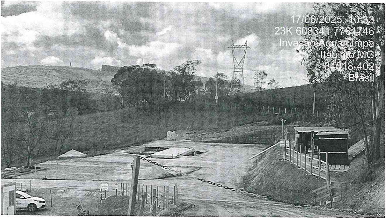
Figura 03: Vista da subestação e as árvores isoladas no entorno.
