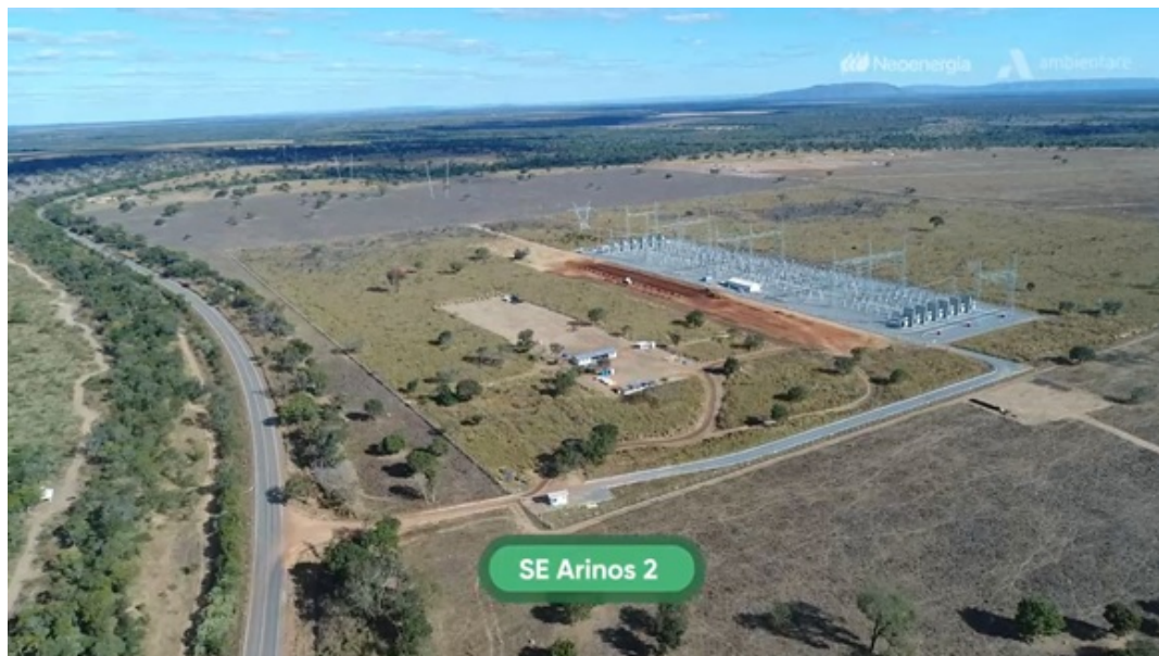
Figura 3. Imagem aérea da Subestação Arinos 2
