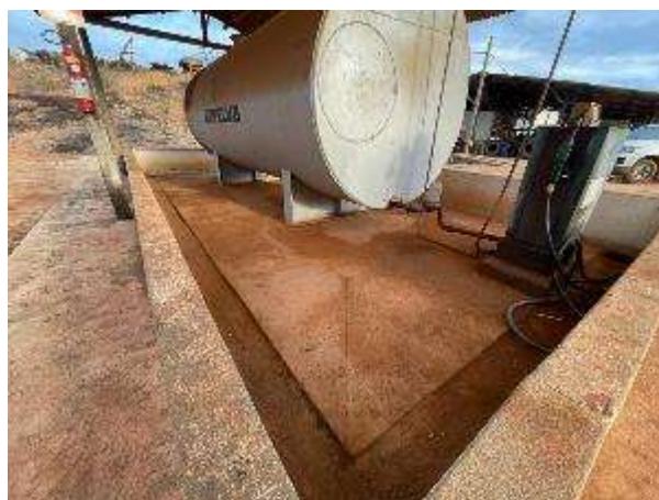
Foto 04. Tanque/ponto de abastecimento com piso impermeável e mureta de contenção.
