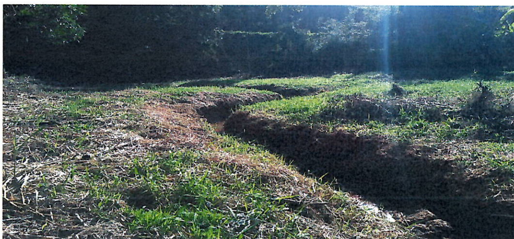
Figura 09: Início do meandro ao qual deseja-se retificar, percebe-se calha regular e profunda. Foto tirada 03/05/2021.
